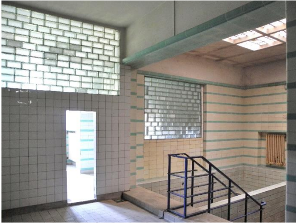
Tauchbecken der Sauna
