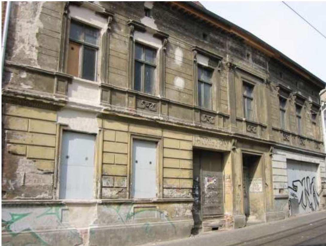
Das Haus nach der Notsicherung 2003. J. Müller
